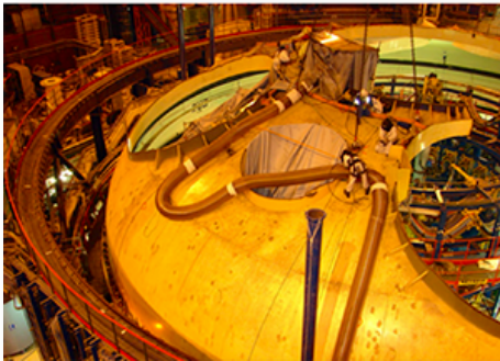
Vue intérieure de la centrale de Creys-Malville (EDF). ©
