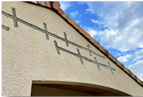
Les fissures causées par la sécheresse sur cette maison ont dues être colmatées. - © Estelle Pereira / Reporterre
