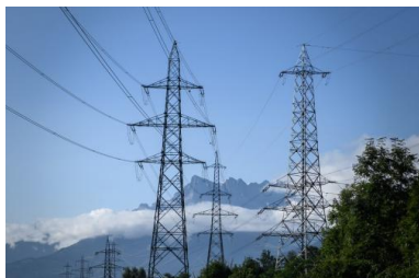
Réseau de lignes à haute tension dans les Pyrénées © Fabrice Coffrini/ AFP
