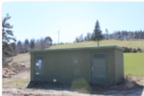
Un poste de transformation électrique, en Lozère, près d'un champ d'éoliennes.
