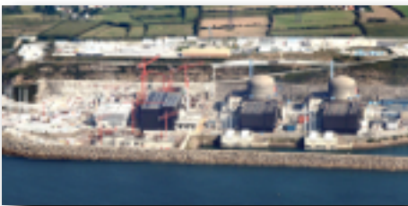
L'EPR de Flamanville dont la mise en service est prévue pour 2018. © Laurent GRANDGUILLOT/REA
