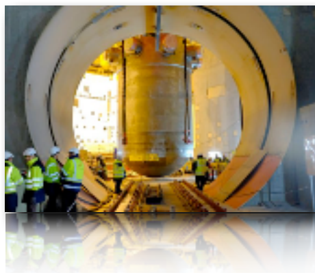
Cuve de l'EPR de Flamanville © Maxppp / PQR Ouest France/Gilles Collas
