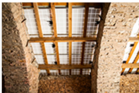
Les panneaux photovoltaïques installés par Lum del Larzac sur le toit de la bergerie. © David Richard / Reporterre
